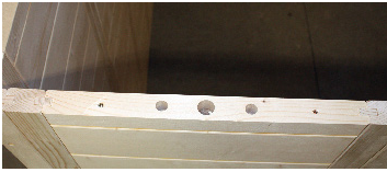
Élément électrique à gauche - sortie d'air derrière à droite.
